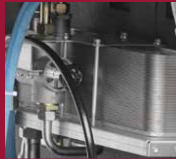
Wärmerückgewinnung zur Warmwasseraufbereitung
