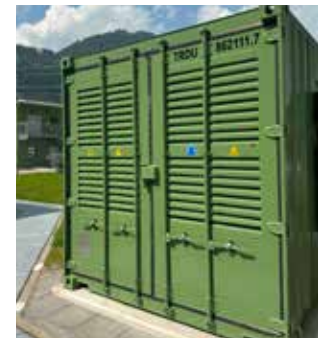
2-flügelige Wartungs- und Zugangstüren vorne mit Zuluftöffnung
